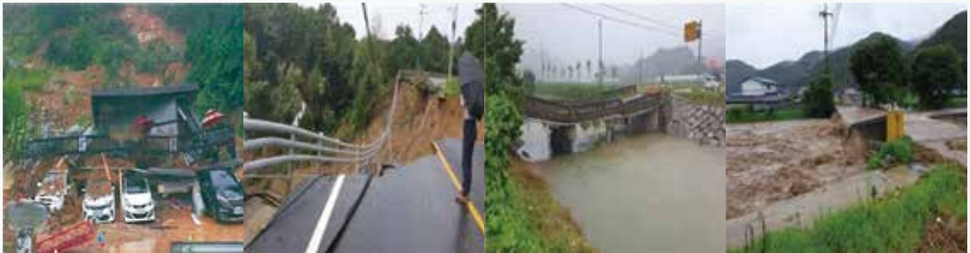
[사진 3-8-1] 장마기간 발생한 피해 모습
